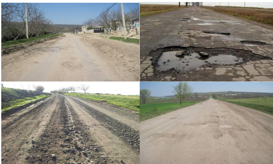
Figura 2-10: Degradări ale drumurilor locale
